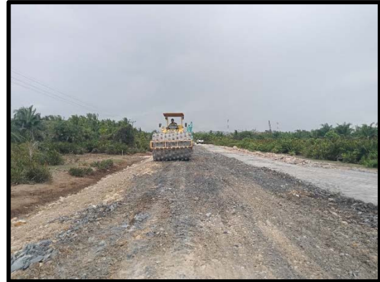
งานลงวัสดุชั้นดินถมคันทางพร้อมบดอัด กม. ๒+๑๕๐ - ๒+๓๐๐
