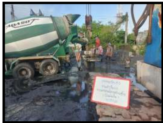
ภาพแสดงงานลงเหล็กและเทคอนกรีต โครงสร้างเสาเข็มเจาะ A3 งานทางลาดผู้พิการ LT (ฝั่งแผ่นดิน)
