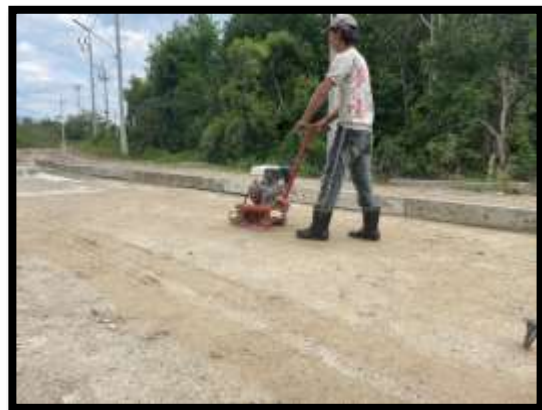
ภาพแสดงงานเข้าแบบข้างงานถนน พร้อมปรับเกลี่ยและบดอัดชั้นทรายหยาบ Sta.๐+๓๕๘ ถึง Sta.๐+๕๐๐ RT
