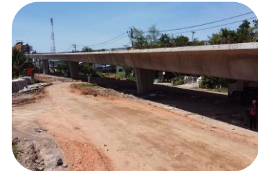
งานติดตั้ง Precast Box Segment (P3-P4, P4-P5 และ P5-P6 )
