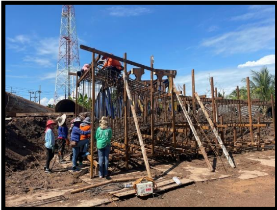
ภาพแสดงงานผูกเหล็กโครงสร้างเสาตอม่อ (P๗)
