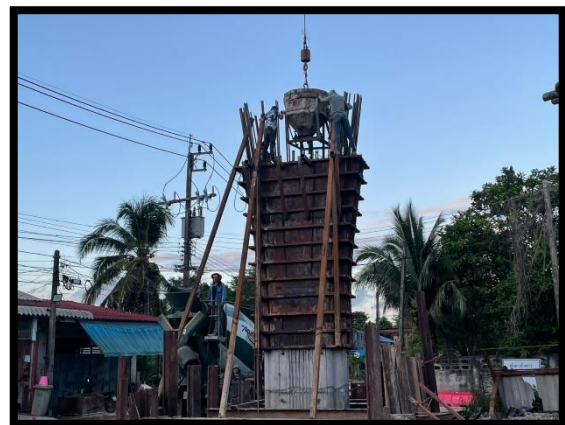
ภาพแสดงงานเทคอนกรีตเสาตอม่อ (P๔) ช่วงที่ ๒
