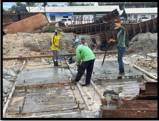
ภาพแสดงงานเทคอนกรีตผนังแบบหล่อฐานราก (P๔)
