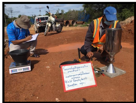
ภาพแสดงงานทดสอบความหนาแน่นของทรายถมคันทาง ช่วง Transition
