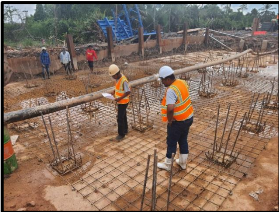
การตรวจสอบเหล็กเส้นเสริมสำหรับโครงสร้างงาน พื้น Transition (ฝั่งเริ่มต้นสะพาน)
