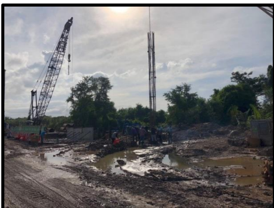
งานเสาเข็มเจาะขนาดเส้นผ่านศูนย์กลาง ๐.๘๐ ม. (Abutment)
