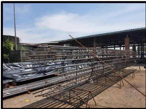
งานเหล็กเสริมคอนกรีตเสาเข็มเจาะขนาดเส้นผ่าน ศูนย์กลาง ๐.๘๐ m. (Abutment)
