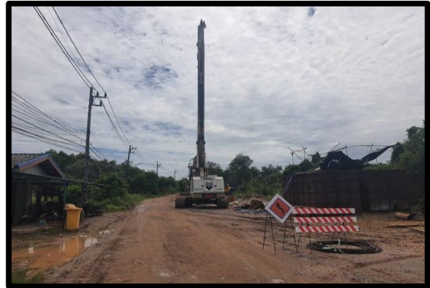
งานเสาเข็มเจาะเส้นผ่านศูนย์กลาง ๐.๘๐ m. (Abutment)
